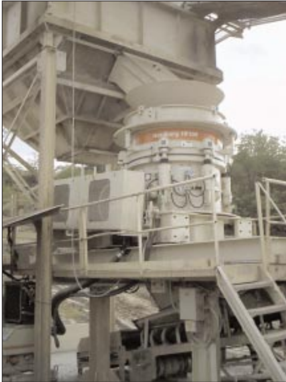
A COLAS Északkó Kft. Nógrádkövesdi Üzemében 2004 májusában beépített és beüzemelt Nordberg HP 3000 kúpostörő 250 t/ó andezit másodlagos törésére
